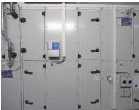
/ Die Zentrale: Hinter diesen Türen befinden sich Feinfilter, Wärmetauscher und Ventilatoren der Anlage.
