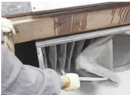
/ Blick in die Box: Damit sich die relativ teuren Taschenfilter nicht so schnell zusetzen, wurde später ein preiswerter Vorfilter ergänzt, der öfters ausgetauscht wird.
