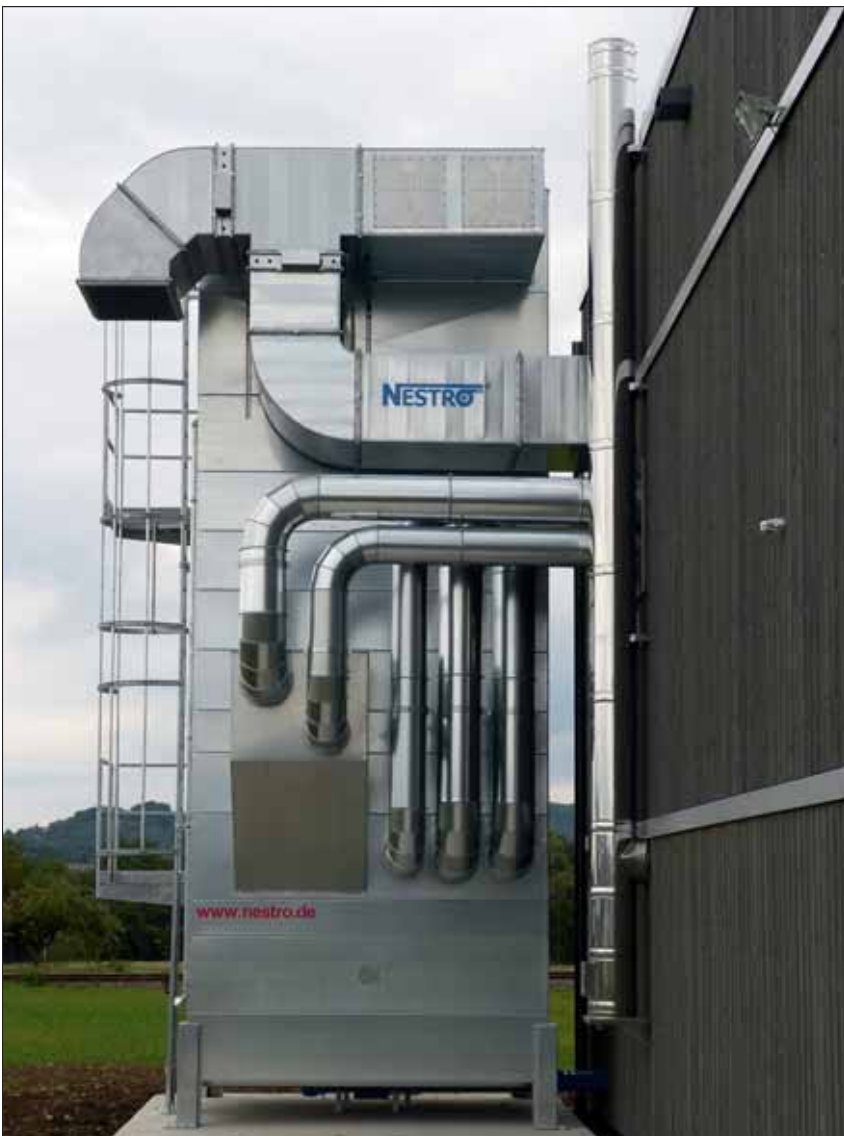
Bis zu 39000 m 3 /h saugt die neue Anlage ab. Im unteren Teil des Filtergehäuses werden die aus den Filterschläuchen abgerüttelten Holzpartikel gepuffert ...
