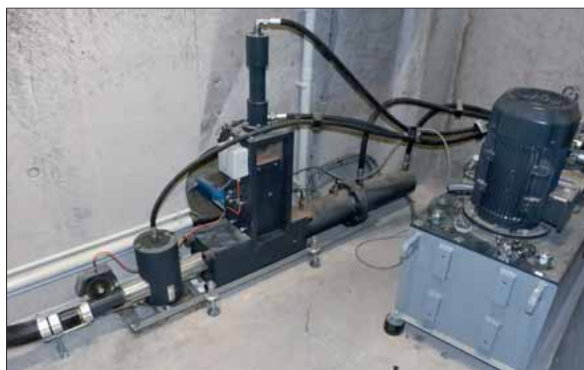
... und dann nach Erreichen eines definierten Füllstandes in der Brikettpresse komprimiert. Diese befindet sich geschützt vor Witterungseinflüssen im Innenraum
