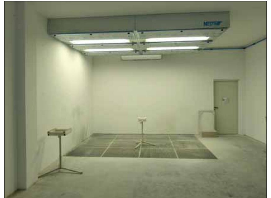
Im oberen Teil des Spritzstandes werden 80 % der Zuluft zugeführt, im unteren Teil die gesamte Abluft abgesaugt
