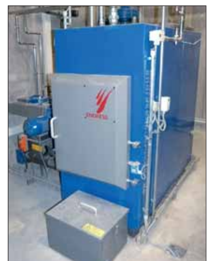
Die Briketts landen im eigenen Kessel
