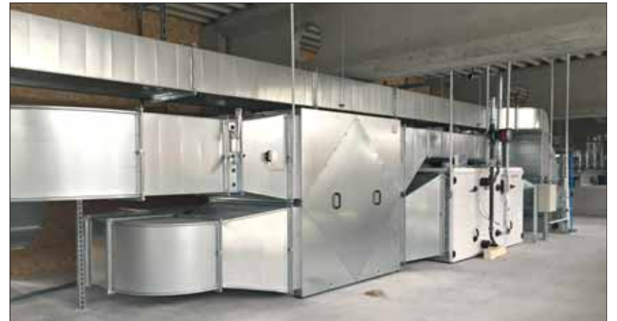
Die meisten Teile der Lufttechnik der Farbnebelabsaugung, wie hier im Vordergrund der Kreuzstromwärmetauscher, befinden sich im Raum über der Spritzkabine
