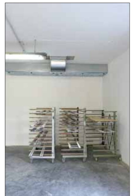
20% der Zuluft strömen im Abdunst- und Trockenbereich zu
