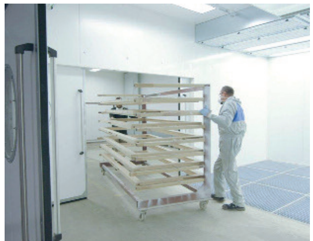
In einem separaten Hallentrakt entstand durch Nestro eine Lackierkabine für hochwertige Oberflächen inklusive Lackaufbereitung.
